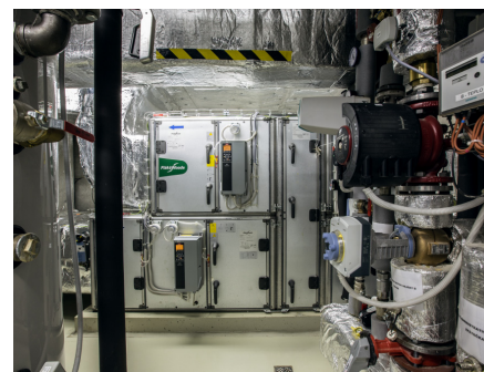
Centrální VZT jednotka s rotačním rekuperátorem FläktWoods o výkonu 4500 m 3 /hod umístěna v technické místnosti. Distribuuje čerstvý vzduch pro až 180 lidí v kancelářích a zasedacích místnostech. (Zdroj: Aliance pro energetickou soběstačnost)
