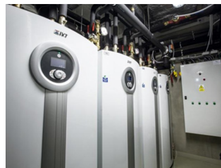
Tepelná čerpadla v technické místnosti Nadace Partnerství (Zdroj: Aliance pro energetickou soběstačnost)
