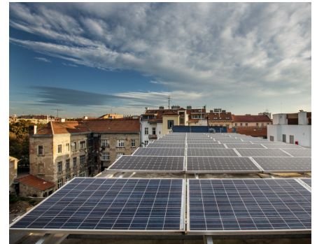
Fotovoltaická elektrárna na střeše Otevřené zahrady. (Zdroj: Aliance pro energetickou soběstačnost)
