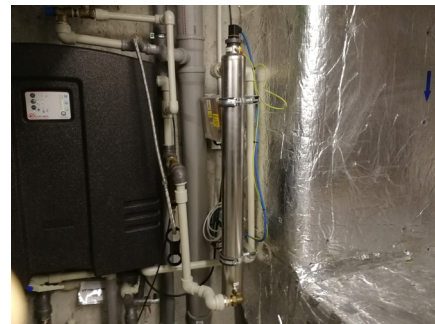
UV-C lampa v technologické místnosti Otevřené zahrady eliminuje bakteriální znečištění před tím, než se recyklovaná dešťová voda rozvádí do toalet. (Zdroj: Archiv Nadace Partnerství)
