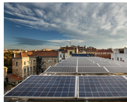
Fotovoltaická elektrárna na střeše Otevřené zahrady. (Zdroj: Aliance pro energetickou soběstačnost)
